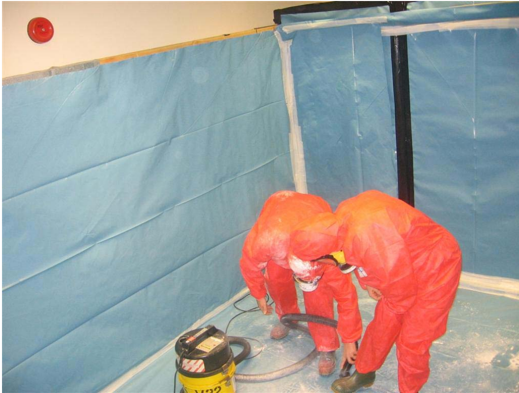
Abb. 7.1 Praktische Übung in der Verwendung eines H-Typ Staubsaugers, um simuliertes kontaminiertes Material (Talkpulver) zu entfernen. Diese Abbildung wurde von dem britischen HSE zur Verfügung gestellt.
