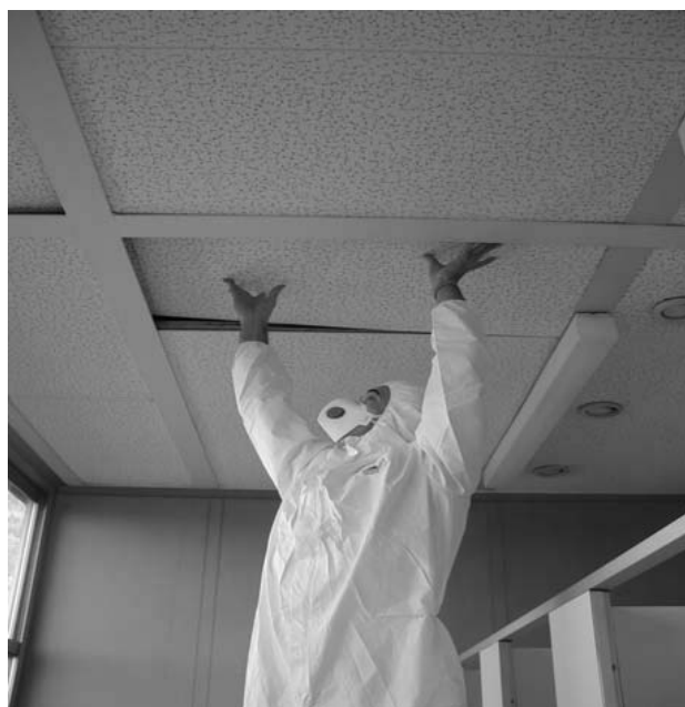
Asbesthaltige, abgehängte Deckenplatte (Akustikplatte), Foto IST
