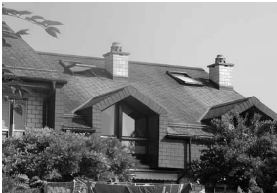
Dachschiefer aus Asbestzement, Foto IST
