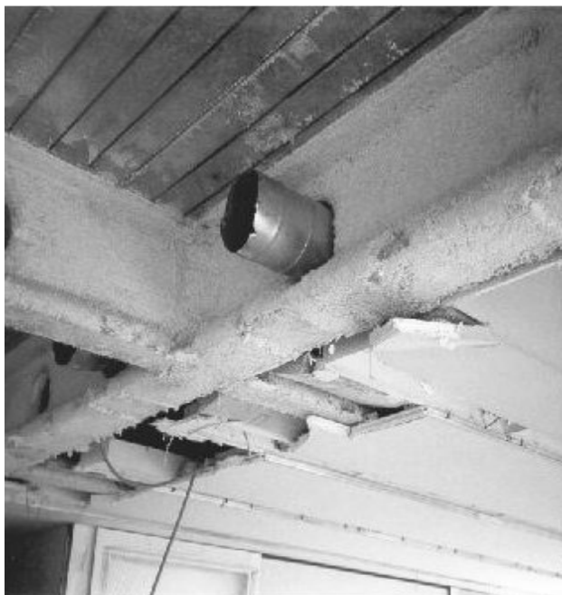
Spritzasbest an einer metallischen Tragkonstruktion, Foto IST
