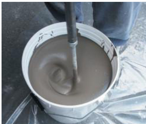
Mischvorgang mit Rührwerk
