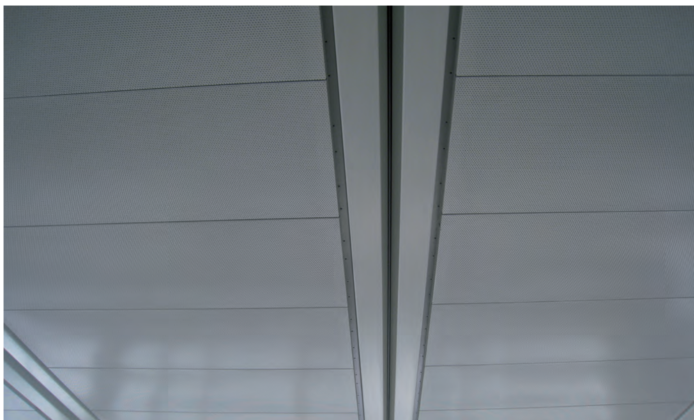
Untersicht: Akustikausführung mit perforierten Planum-Profilen
